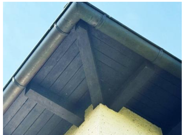
Abb. 25: Dachüberstand ohne erkennbare Spalten mit Quartiereignung.
