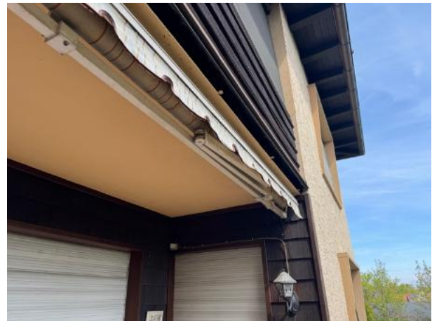
Abb. 23: Südseite des Gebäudes mit zahlreichen Nischen und Spalten.
